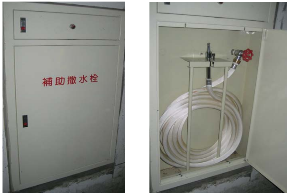
圖 2-24 補助撒水栓（資料來源：同註 1）
